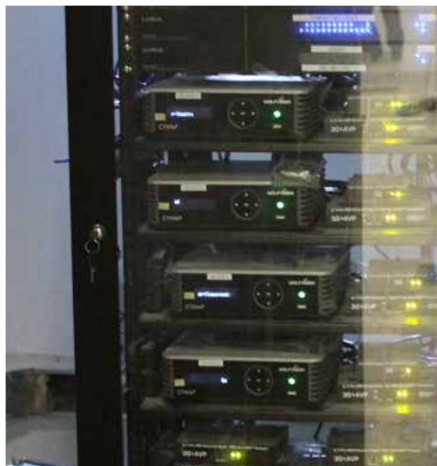
Cynap-Systeme in Rack-Montage bei EMSD
